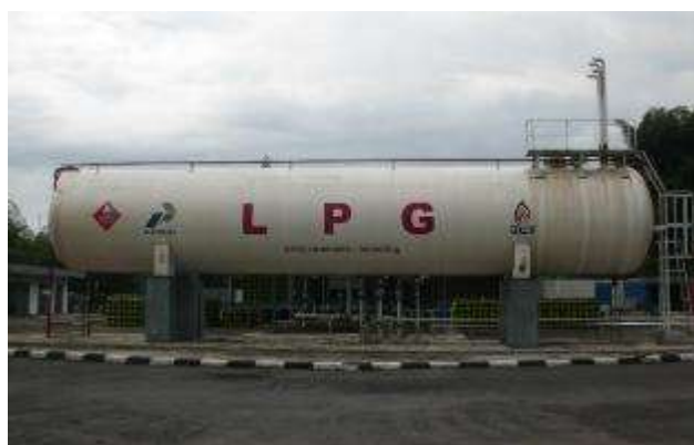
Gambar 3. 2 LPG storage tank yang diteliti
